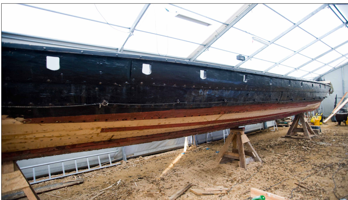
Bagbord side med reparationer
