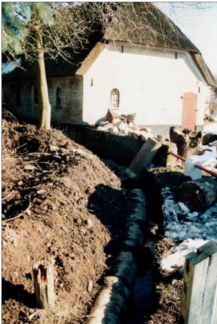
De gamle rør var ikke i særlig god stand.
