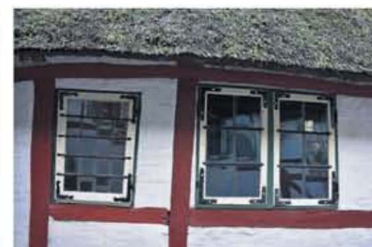
Alle ruder er blyindfattede. Vinduet til venstre er ejendommens ældste og måske helt fra 1700-tallet. Foto: Birthe Juul Mathiosen
